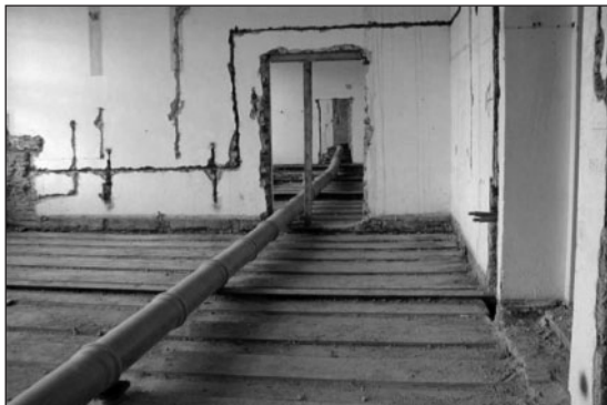
Savice a odsávací potrubí o průměru 25 cm se na staveništi k jednotlivým pracovištím přivádí buď po lešení, nebo vnitřkem objektu.
