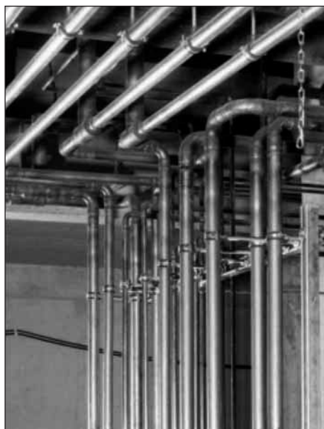
Rozvodná soustava provedená pájením.
