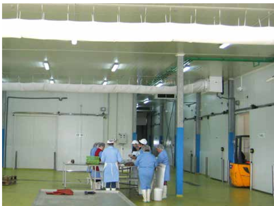
Studený vzduch (die kalte Luft) z kubických chladičů vzduchu Güntner GHN je do pracovních prostor přiváděn textilními rukávci (strömt über Textilschläuche in die Arbeitsräume)
