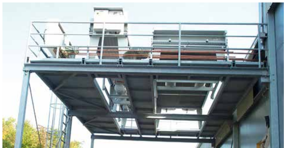
Kondenzátor na ocelové konstrukci vedle strojovny
