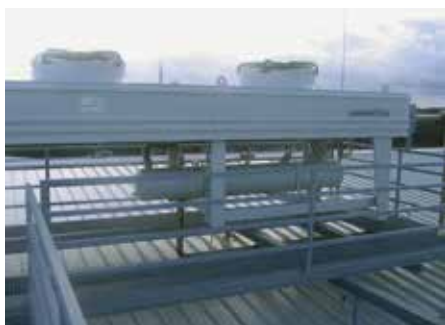
Kondenzátor Güntner S-GVH 090 s podchlazovačem na střeše strojovny
