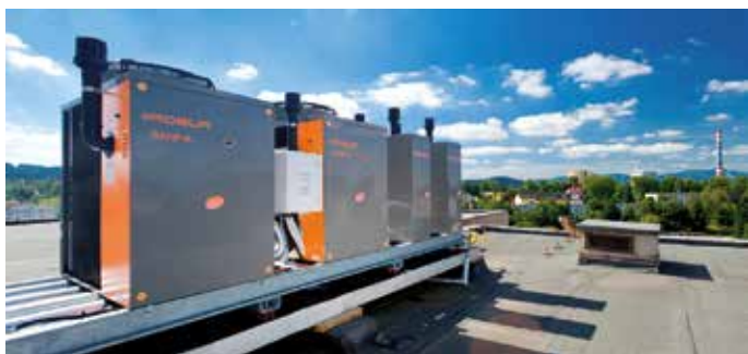
Kaskáda plynových absorpčních tepelných čerpadel GAHP (link) na střeše bytových domů v Jablonci nad Nisou
