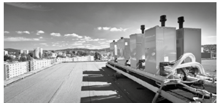
Střecha bytových domů v Jablonci nad Nisou s novým kompaktním zdrojem tepla
