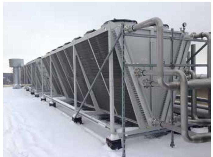
Suchý chladič kapaliny (Trockenkühler) GFD na střeše budovy: V zimě je veškeré odpadní teplo (Abwärme) kompresorů využito pro vytápění (Heizzwecke). V létě je to teplo, které není potřebné, odváděno prostřednictvím jednoho kondenzátoru (Verflüssiger) Güntner V-SHAPE Vario typu GVD a tří suchých chladičů kapaliny/výměníků pro získání odpadního tepla (Flüssigkeitskühler/Rückkühler) Güntner V-SHAPE Vario typu GFD (viz obr.).
