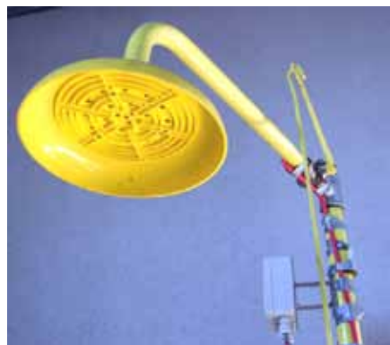
Tělní sprcha interiérová, dodatečně amatérsky „omotána“ topným kabelem upevněným lepicí páskou. Rameno se nevyhřívá, chybí izolace, ohřev je neúčinný, sprcha zamrzá
