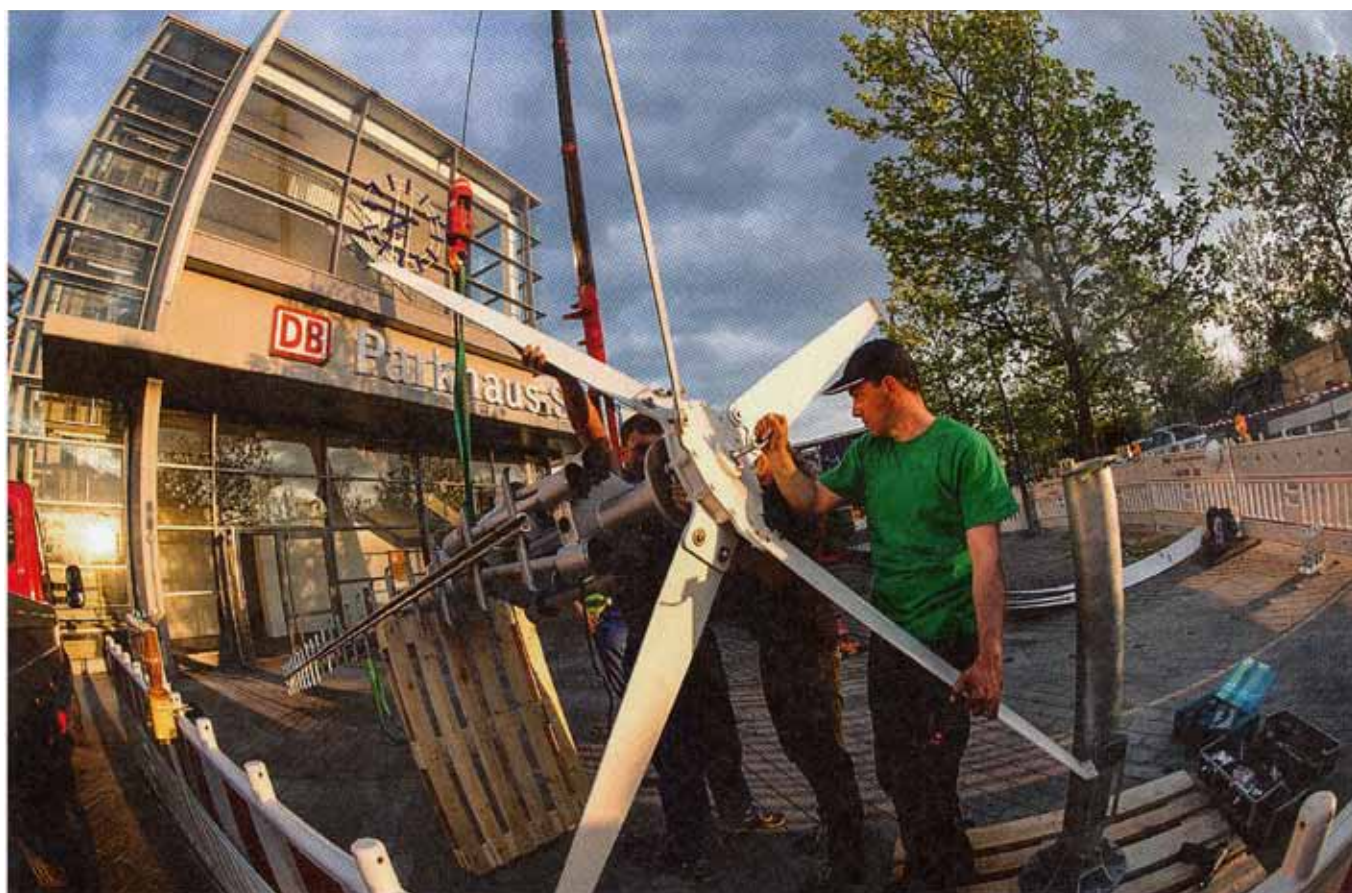
Obr. 1 Technici instalují malou větrnou elektrárnu na střechu nádraží Berlin Südkreuz
