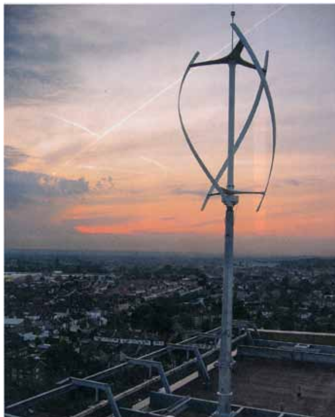
Obr. 3 Malá větrná elektrárna na střeše. Tyto siluety jsou zvláště oblíbené u architektů
