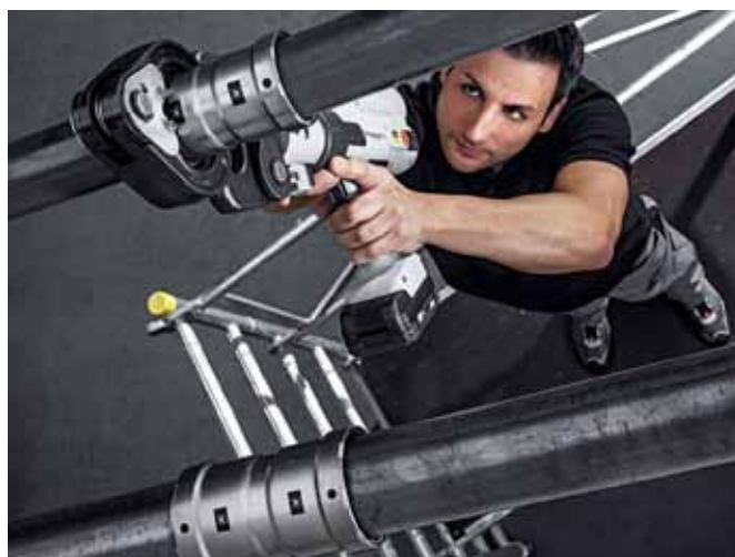
Bez námahy ve srovnání se svařováním: Systémem „Megapress“ společnosti Viega lze bez námahy slisovat ocelové trubky pod stropem. (Foto: Viega)
