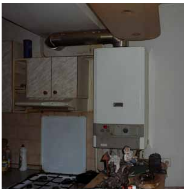
Obr. 1 Celkový pohled na instalovaný plynový kotel
