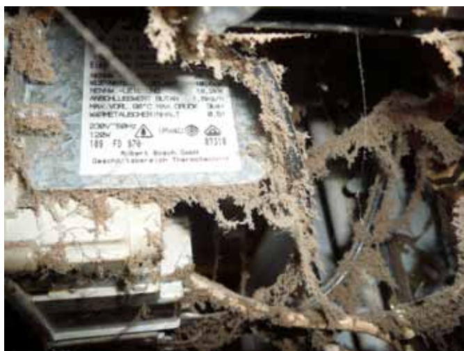
Obr. 4 Detailní pohled na znečištění plynového kotle
