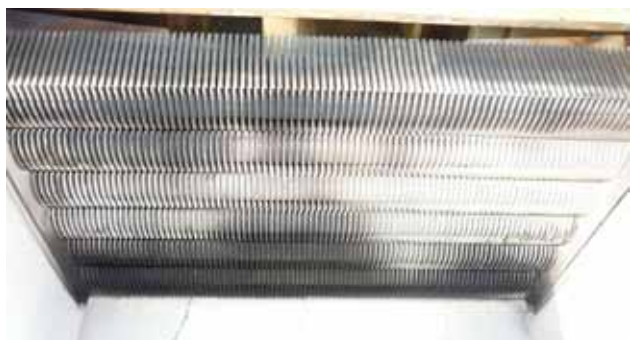
Obr. 11 Detailní pohled na znečištěný výměník kotle z obr. 10
