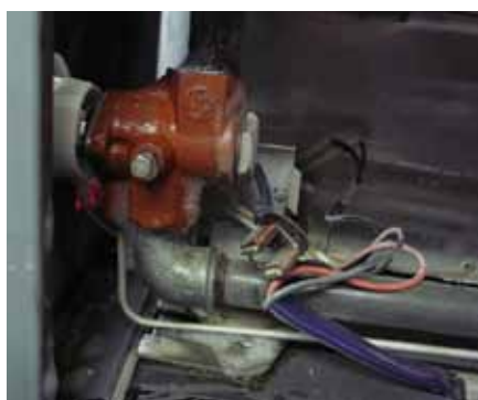
Obr. 5 Detailní pohled na spodní část kohoutu s termoelektrickou pojistkou, kde na trubce v dolní části obrázku leží demontovaná kotva z tělesa pojistky plamene
