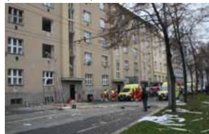
Obr. 8 Pohled na objekt, kde došlo k výbuchu
