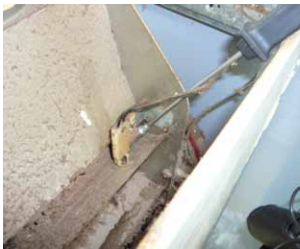
Obr. 7 Detailní pohled na částečně očištěné čidlo pojistky zpětného toku spalín pro účely měření doby reakce k odstavení kotle z provozu
