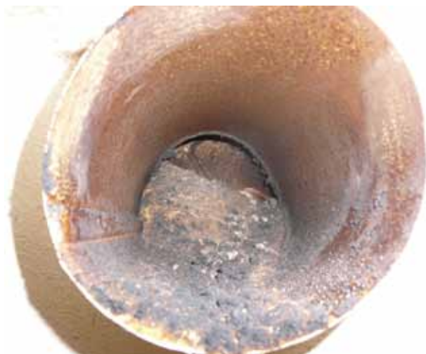
Obr. 5 Pohled do sopouchu a komínového průduchu, který je ze 2/3 uzavřen spadem v komíně
