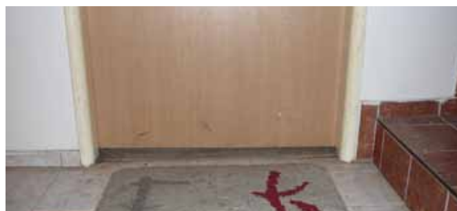
Obr. 2 Pohled na dveře bez otvorů pro přívod vzduchu
