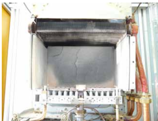
Obr. 10 Pohled do hořákové komory, v dolní části hořák kotle, v horní části výměník se zjevnými stopami znečištění a nedokonalého spalování
