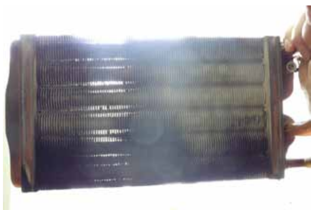
Obr. 12 Pohled proti světlu na znečištěné lamely výměníku
