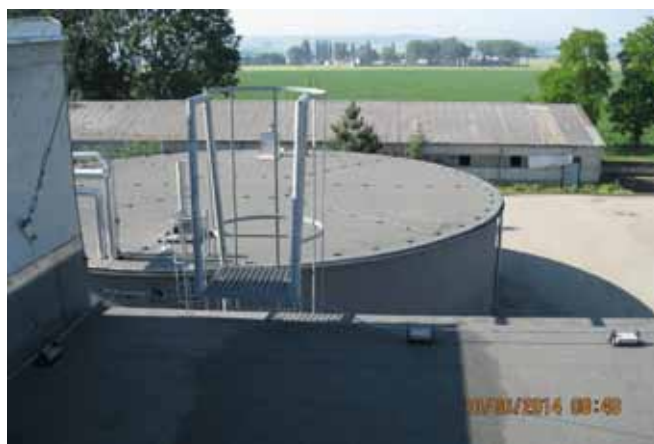
Není zajištěna ochrana zaměstnanců před pádem z výšky při obsluze technického zařízení na střeše budov (foto SUIP.cz)
