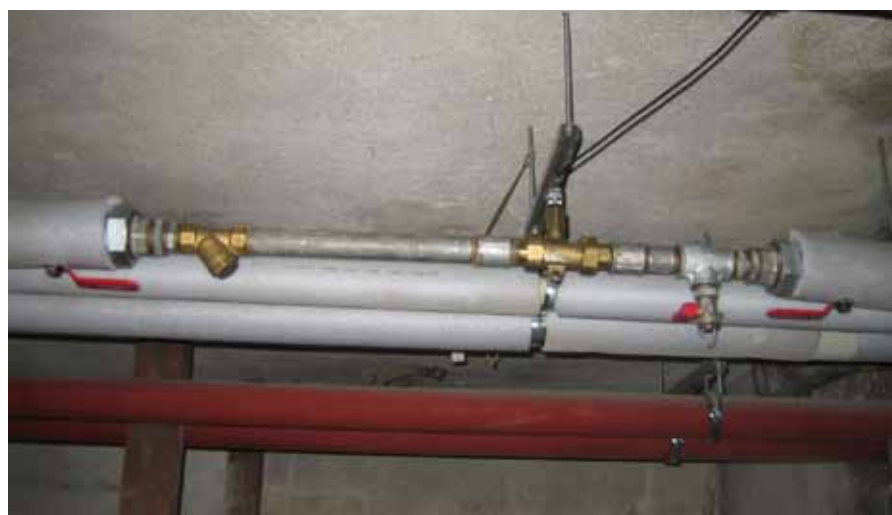
Obr. 6 Osazení průtokoměru v bytovém domě
