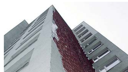
Důsledek neřešení ztráty stability zateplovacího systému
