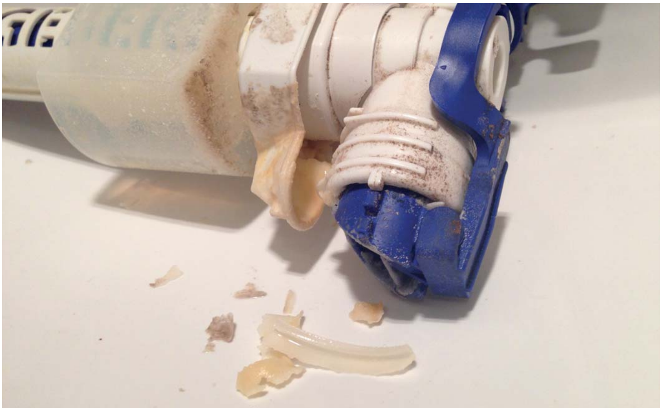
Kámen v nádrže - WC protékající pomalu ale jistě po 5 měsících po kompletní výměně.
