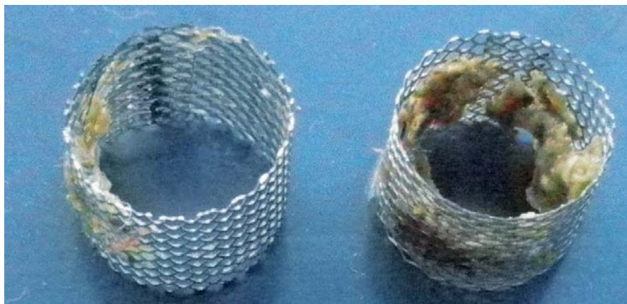
Filtry z ventilů – roháčky – pro připojení umývadlové baterie. Vlevo z PWH, vpravo z PWC (!) po 7 měsících provozu
