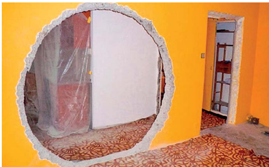
Jeden z odstrašujících případů, který odborníci ČKAIT uvádějí: Majitelka si nechala ve stěně vytvořit velký kruhový průchod. Neověřila si, že jde o nosnou zeď, a nad ní se nacházely další čtyři byty.
