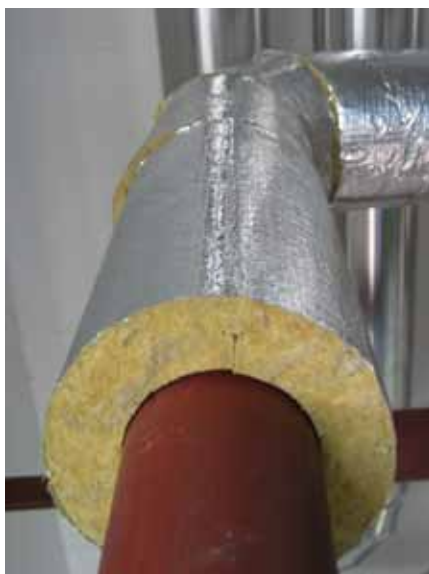
Obr. 2 Použití skruží Knauf Insulation KPS 041 AluR v kotelně bytového domu
