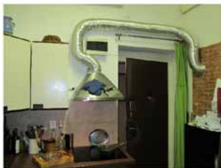
Obr. 29 Digestoř v provozu při současném použití kotle v koupelně zavinila smrt
