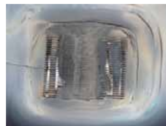
Obr. 5 Zanesený výměník průtokového ohříváče
