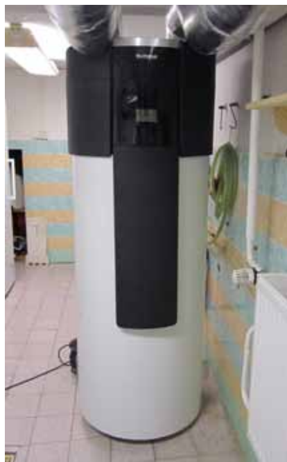
Začlenění do technické místnosti (vzduchovody plastové z příslušenství Buderus doplněny minerální izolací)
