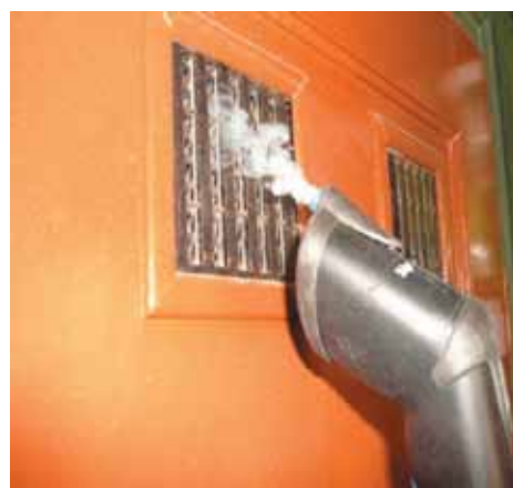
Obr. 18 Ukázka použití přístroje ke kontrole proudění vzduchu
