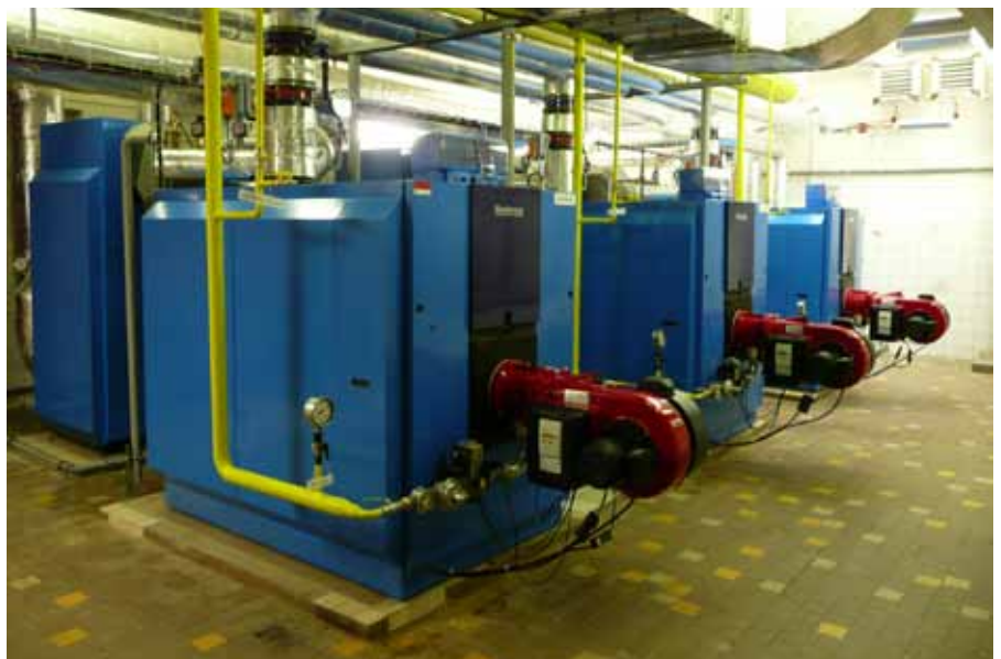
Obr. 1 Kaskádová kotelna s kotli Logano plus GE615
