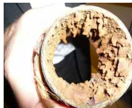
Obr. 1 Ocelové pozinkované potrubí u rozvodu teplé vody po 2,5 letech od instalace
