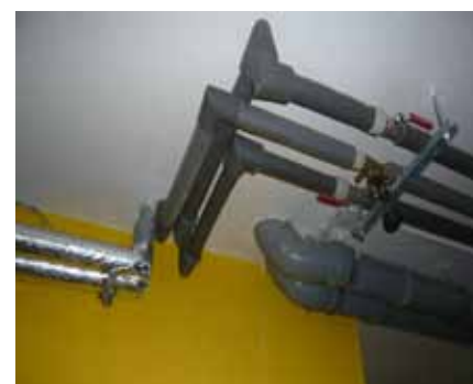
Obr. 2 Vnitřní vodovod - ležaté izolované rozvody na společném závěsu
