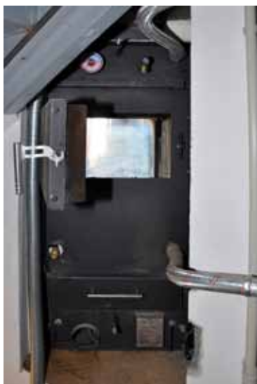
Pohled na otevřené zadní přikládání interiérového kotle, které je orientováno pod schody do podkrovní
