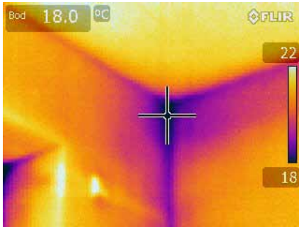
Obr. 11 Ukázka termovizního snímku rohu místnosti
