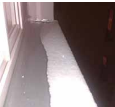
Obr. 12 Hranice sněhu na parapetu okna řešeného objektu
