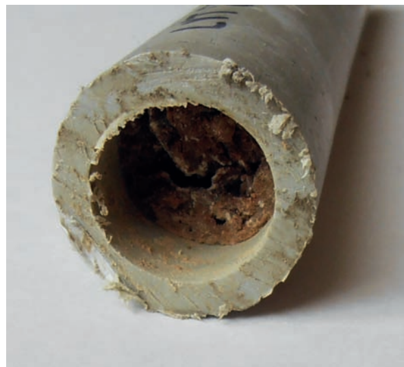
Obr. 6. Usazenina v plastovém potrubí teplé vody vystupující z energetického aparátu po roce provozu
