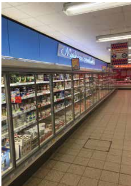
Čtrnáct metrů dlouhý chladicí regál pro mléčné produkty je od ledna 2018 provozován s chladivem R407H (Foto: Daikin)
