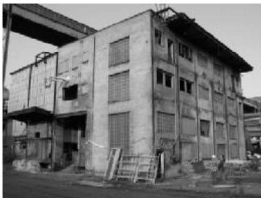
Obr. 1: Budova odstředivek Čpavkárny II. v areálu závodu Mittal Steel Ostrava připravená ke zkoušce
