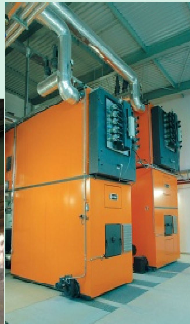
Kotle Schmid 2,4 MW a 1,6 MW
