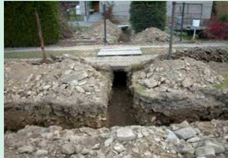
3 km rozvodů, 65 předávacích stanic
