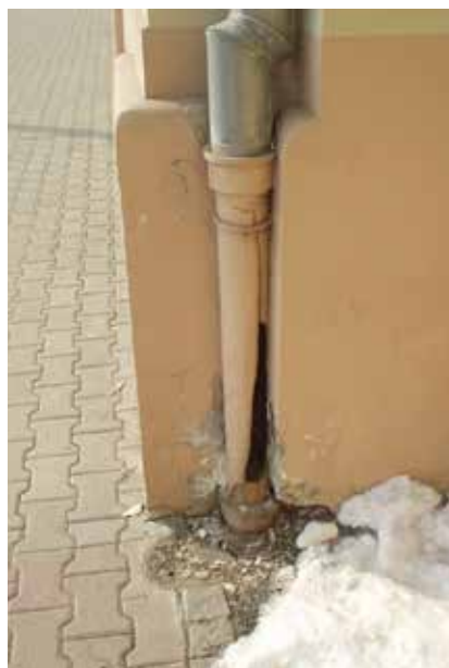
Obr. 10 Trubka prasklá mrazem (zanešený lapač)
