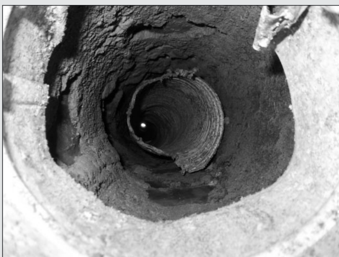
Stav komínu krátce po výměně spotřebiče na zemní plyn. Revize spalinové cesty před výměnou spotřebiče nebyla provedena. Vlivem koroze se utrhl přípojovací T-kus od komínových vložek.
