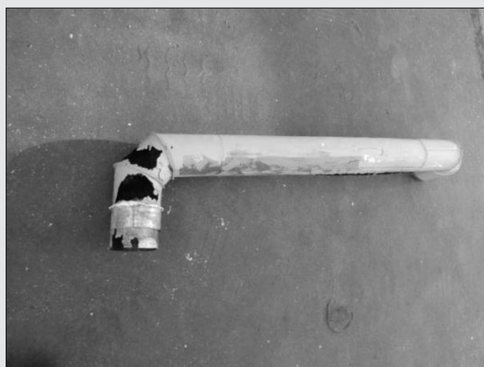
Stav kouřovodu krátce po výměně spotřebiče na zemní plyn. Revize spalinové cesty před výměnou spotřebiče nebyla provedena. Vlivem působení kondenzátu došlo ke korozi pozinkovaného plechu, ze kterého byl kouřovod proveden.
